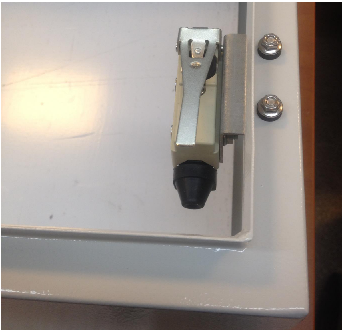
Рис.3.3.9.-1 Установленный выключатель вскрытия.
