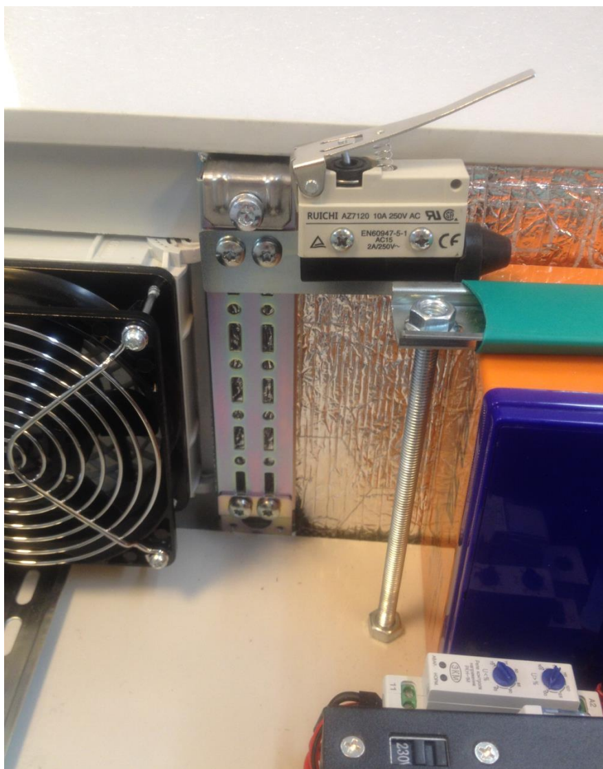
Рис.3.4.10-1 Установленная шина внутреннего монтажа совместно с датчиком вскрытия
